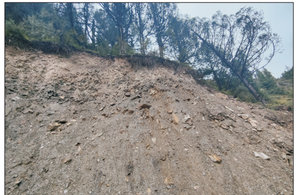
b 林区边坡坍塌
