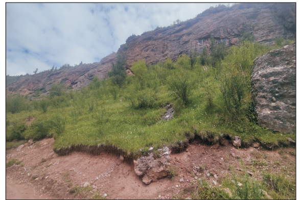
b 道路边坡滑塌
