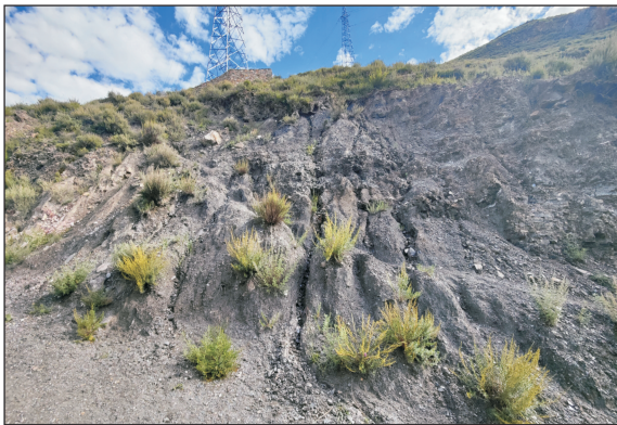
a 道路边坡侵蚀状况
